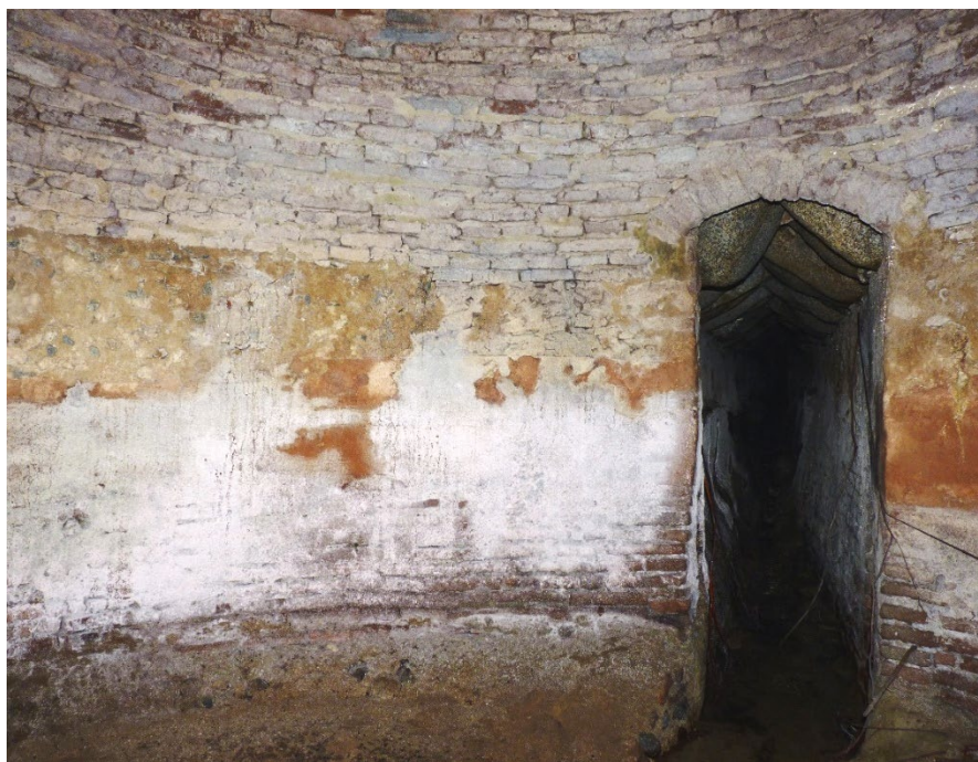
La vasca di decantazione
